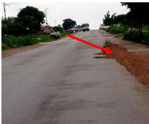
Figure 9 : Epaufrure au niveau de Gankpètè dans l'arrondissement de Tré. (Prise de vue : Hessou, mars 2022)
