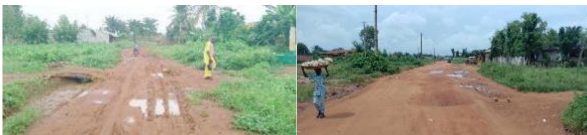
Figure 5 : Etat dégradé de quelques pistes rurales dans la commune d'Adjarra. (Prise de vues : M. A. N. A. Hessou, septembre, 2024).
