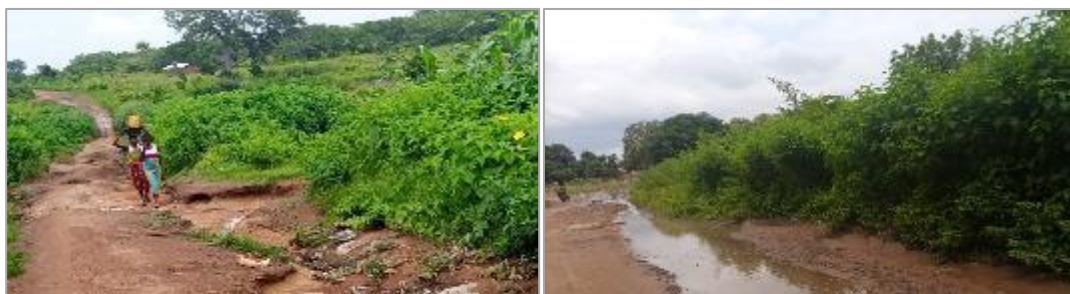
Figure 18 : Piste détruite par l'érosion pluviale à Ouèdèmè. (Prise de vues : Hessou, mars 2022).
