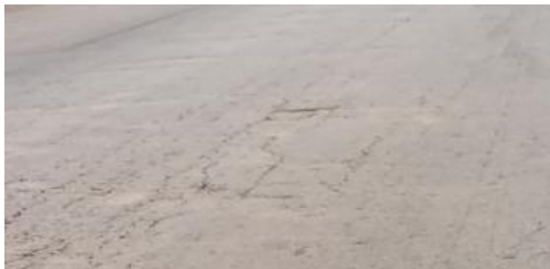
Figure 15 : Fissure longitudinale sur une l'axe Togon dans Dassa-Zoumè. (Prise de vues : Hessou, mars 2022).
