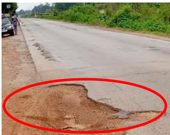
Figure 8 : Epaufrure au niveau de Gbowèlè dans la l'arrondissement Paouignan. (Prise de vue : Hessou, mars 2022).
