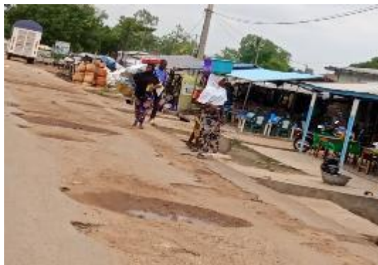
Figure 7 : Nids de poules sur une chaussée de la RNIE 2 dans l'arrondissement de Dassa I. (Prise de vues : Hessou, mars 2022).
