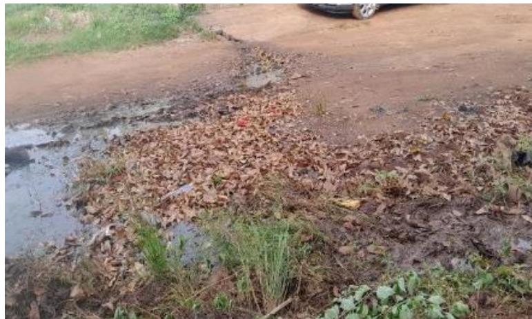
Figure 11 : Evacuation d'eau usée sur la voie publique à Hêvié-Kpota (arrondissement de Malanhoui). (Prise de vue : C. Kiki, septembre 2023).
