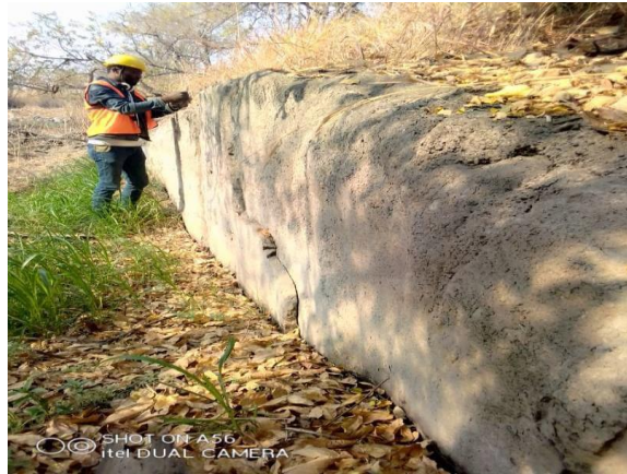
Figure 3 : Démontrant la formation d'une Marne intrudée par des cassures sub-verticales.
