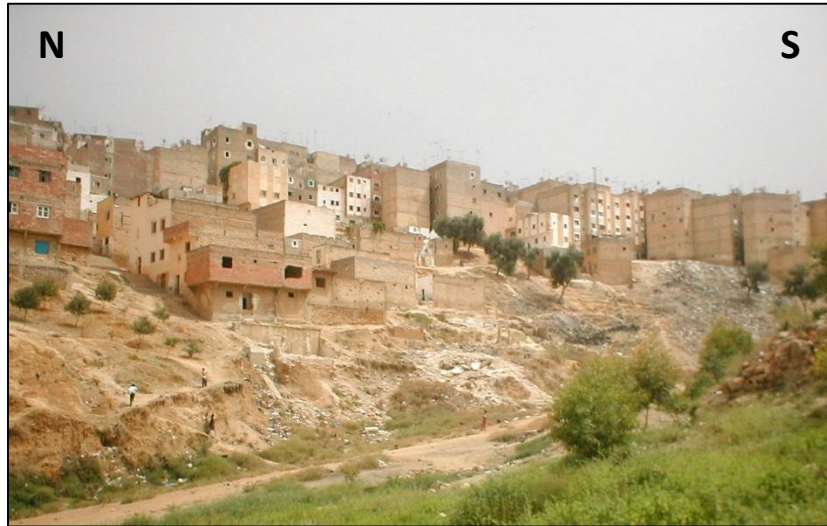
Figure 7 : Photo montrant les constructions d’habitat de Hay Hassani installées sur une topographie inclinée avec des soubassements de maisons effondrées et d’autres soumises aux risques d’écroulement.
