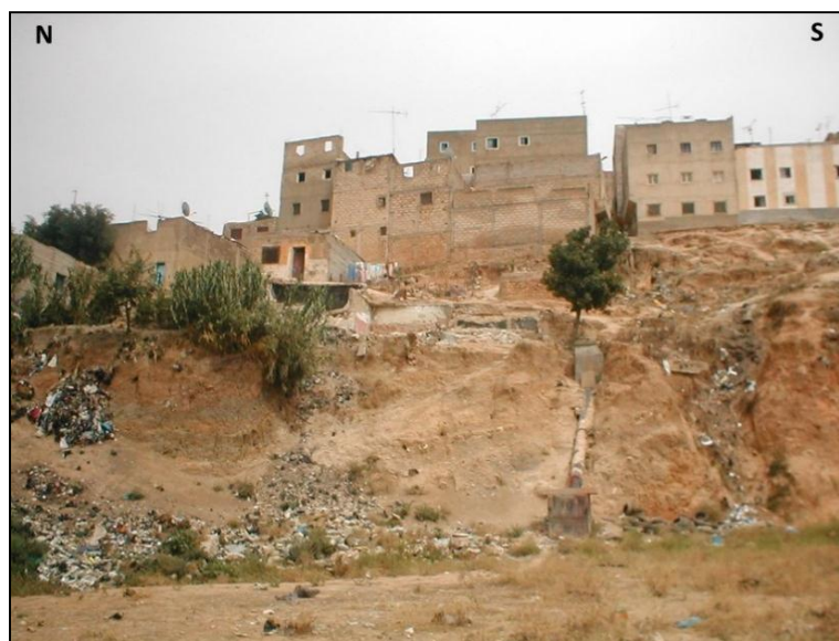
Figure 5 : Photo montrant des soubassements d'habitations effondrées et d'autres soumises au risque d'effondrement des berges de «chaâbat» oued El Maleh à Hay El hassani aggravé par l'infiltration des eaux usées évacuées anarchiquement.
